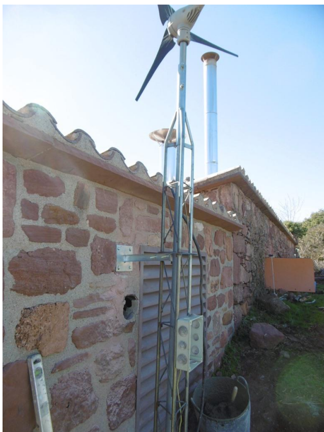
Connexió telemàtica de l'aerogenerador de la masia el
