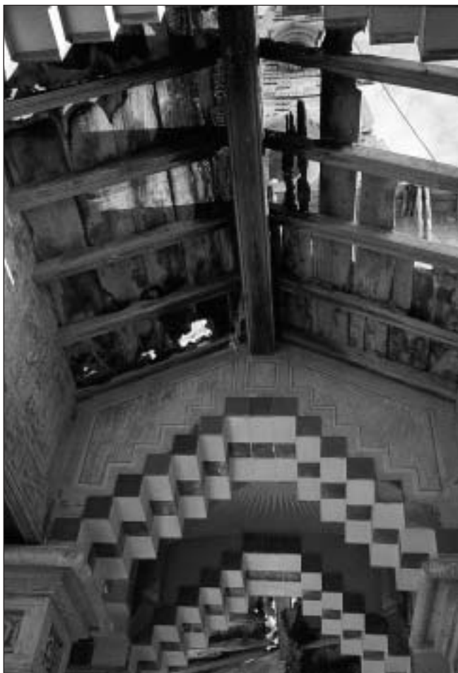
Figura 4. Detall del deteriorament actual de l'interior del safareig.
