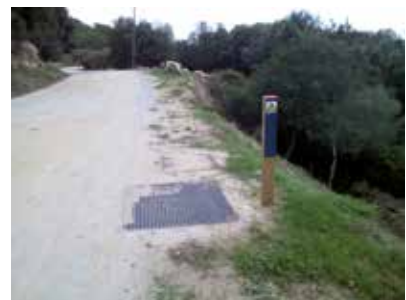
Fites de soterrament de la línia d'alta tensió
