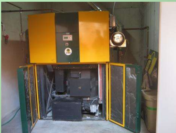
Bellver de Cerdanya: instal.lació i caldera
