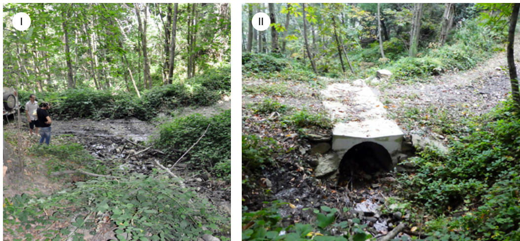
Figura 7. Creació d'un pont per poder donar continuïtat a la llera del torrent i permetre'n el desplaçament de la fauna aquàtica. Les imatges mostren la diferència entre el torrent que anteriorment quedava tallat per la pista forestal (I) i el nou pont construït (II)
