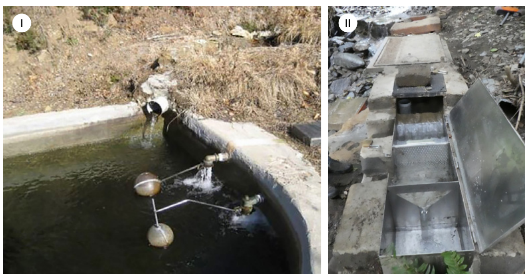
Figura 3. Mecanismes instal·lats per regular l'extracció de l'aigua (I) i caixa de distribució (II)
