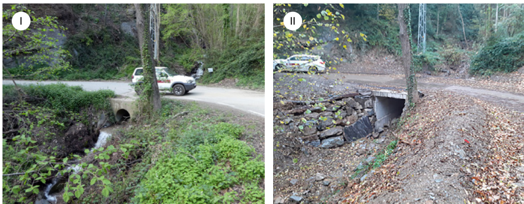
Figura 6. Pont modificat per recuperar la llera del torrent i permetre el desplaçament de la fauna aquàtica. Les imatges permeten observar la diferència entre l'antic pont (I) i el nou (II)
