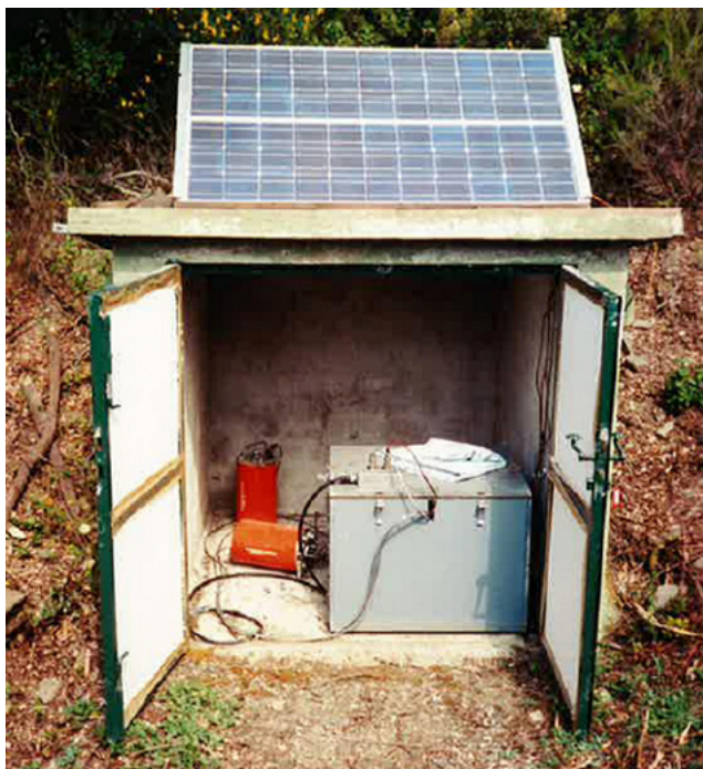
Figura 2. Caseta amb els sensors sísmics abans de la instal·lació del cable de connexió a la xarxa elèctrica
